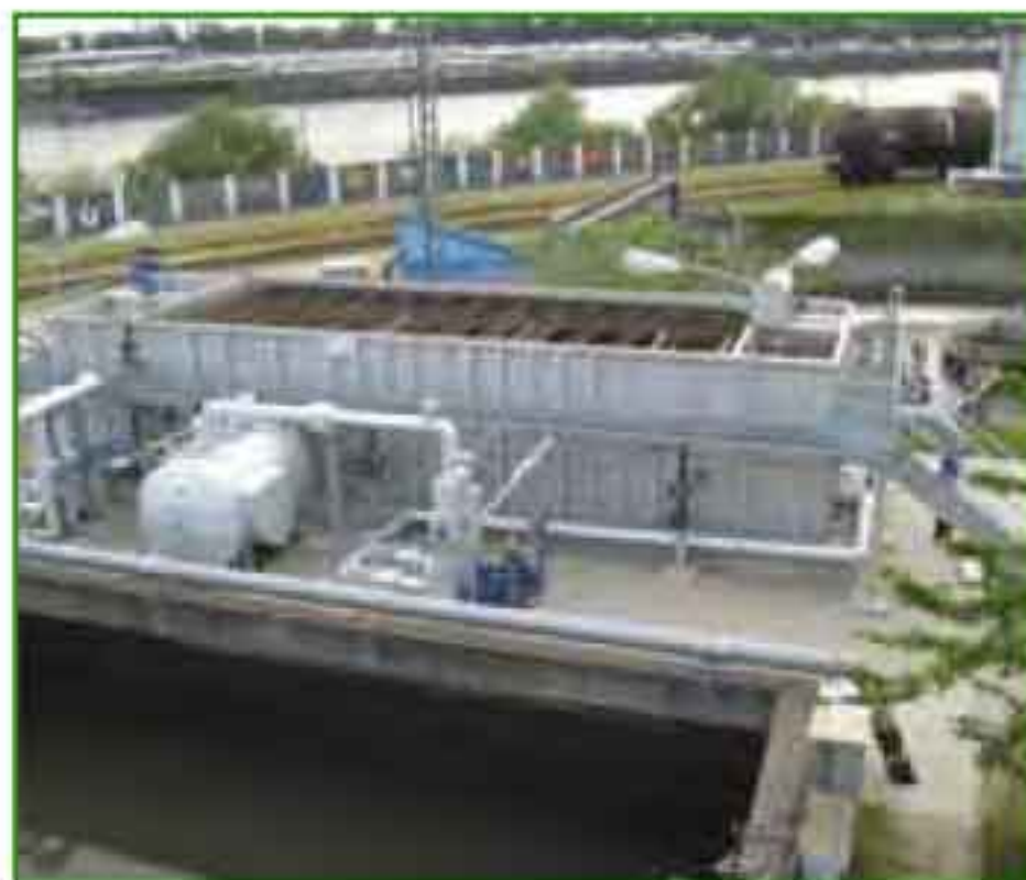
Флотационная установка VODACO-DAF на очистных сооружениях H&R Ölwerke Schindler GmbH (Гамбург, Германия)
