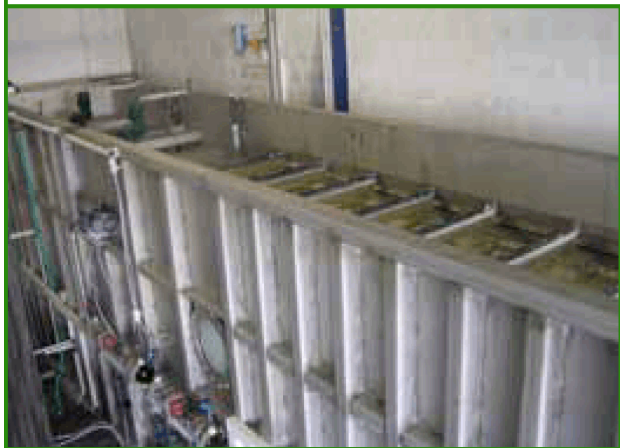
Рис. 1. Флотационная установка для очистки сточных вод
